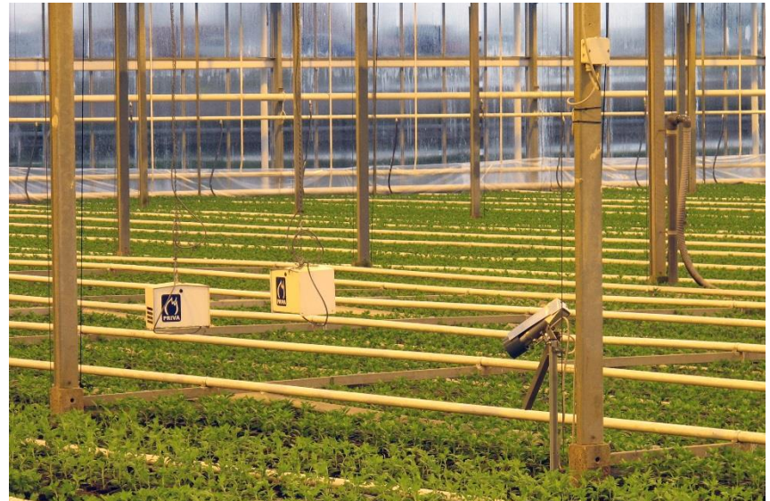
Meetopstelling in chrysantenteelt (Zijdezicht)
